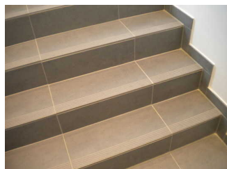
Treppenstufen, taktile aber nicht visuell kontrastreich.
