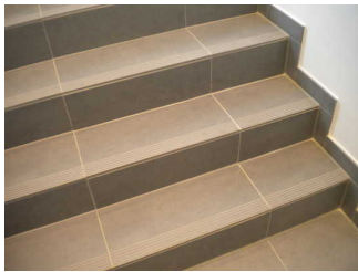
Treppenstufen, taktil aber nicht visuell kontrastreich.
