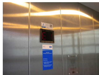
Aufzug Glasmuseum Etagenanzeige
